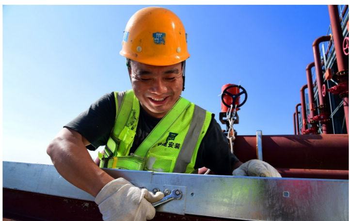
近日,中建安装上海公司在中国金融期货交易所研发基地项目举办“军魂熔铸初心 匠心践行使命”技能比武活动,电气工人顶着烈日操练,助力上海新基建项目高效建设。(郭箫)
