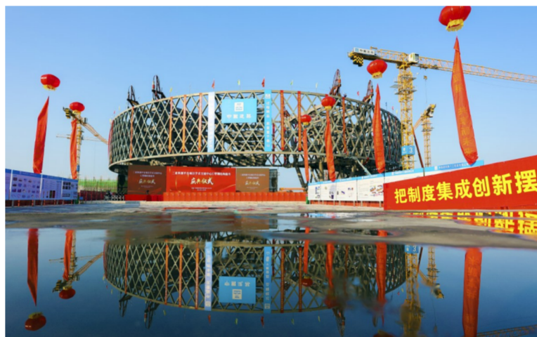
近日,中建六局承建的三亚科创平台项目学术交流中心U型钢结构完成提升,总重量3325吨,创海南省钢结构整体提升三项纪录。(梁深圳)
