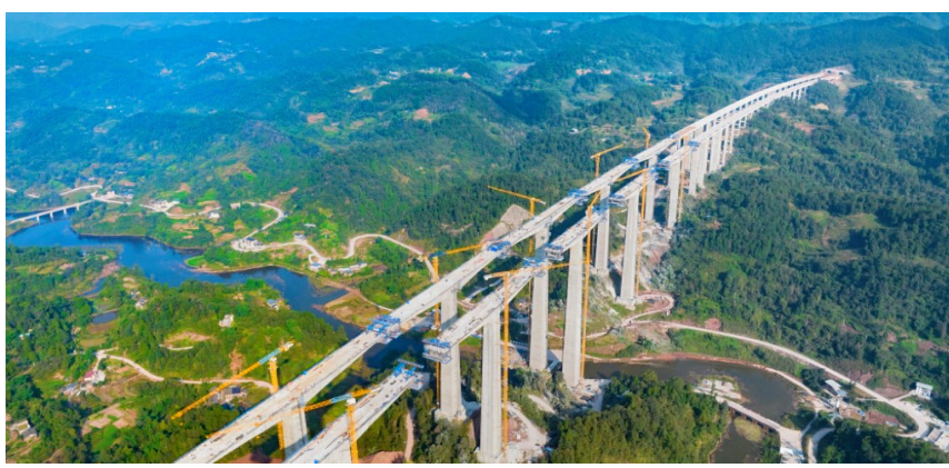
由中建铁投承建的渝湘复线高速公路巴彭路二标段项目左幅全线贯通。项目是国家高速公路网“71118”规划的重要路段,建成后助力重庆主城和渝东南片区旅游资源开发,助力成渝地区双城经济圈打造国际性综合交通枢纽。(梁灏、邢铁)
